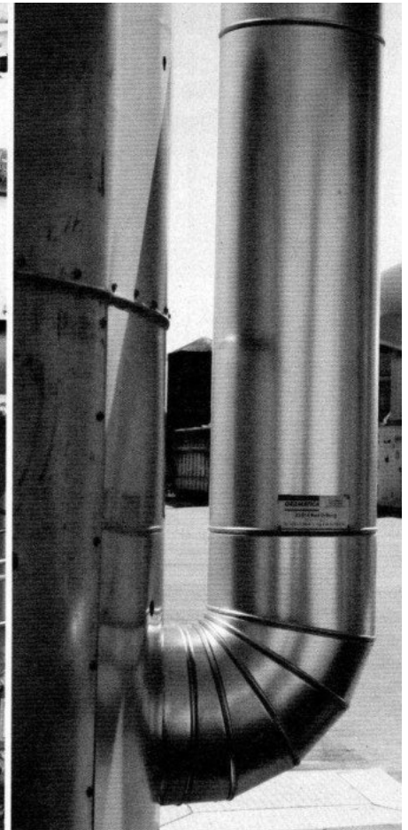
Biogas als Puffer: Die Anlagen des „Biopower2gas“-Projekts sind so ausgelegt, dass sie ausgleichend wirken können.
